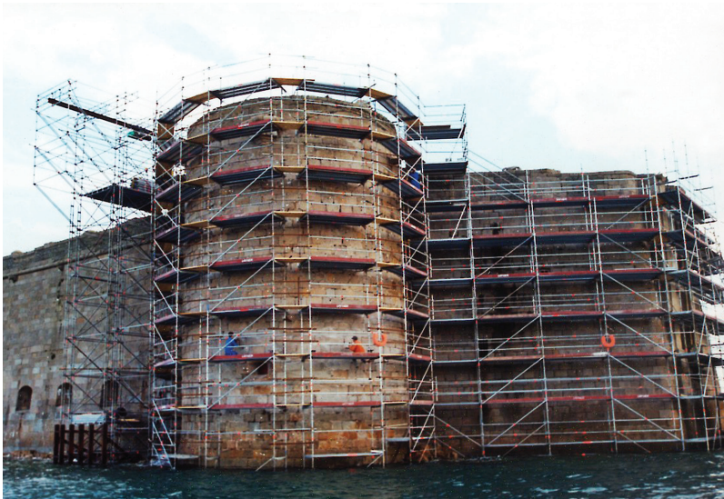
Échafaudage en 2002 du château du Taureau — Château du Taureau under scaffolding in 2002
